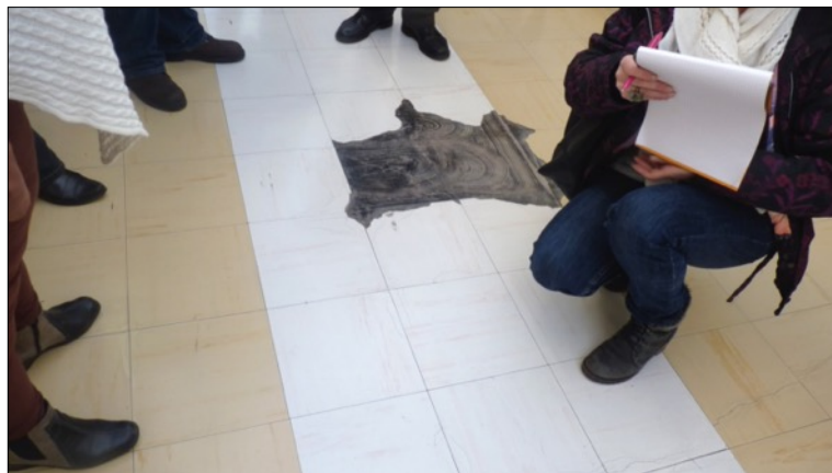
La problématique amiante est alors un enjeu syndical nouveau, les dalles dégradées, un poison.(Photo Emel)
